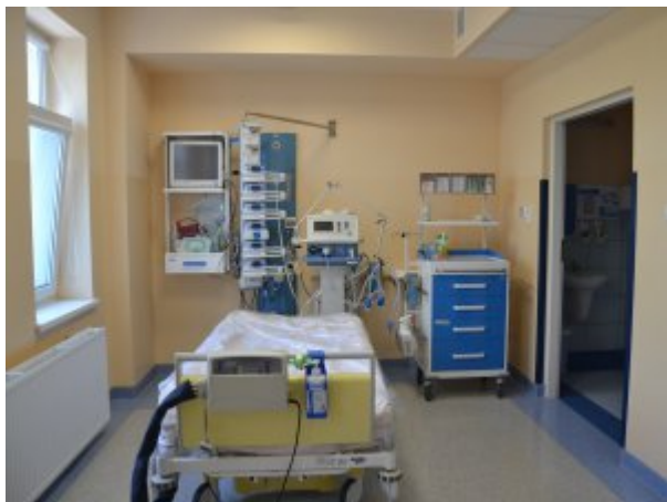
Łóżko z respiratorem wyposażone w panel pomp infuzyjnych, fot. SP WZOZ MSWiA w Bydgoszczy
